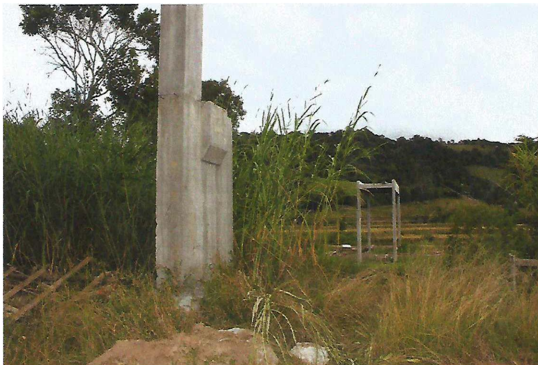
Figura 5 - Ponte Passo da Limeira: Etapa conforme Relatório de Progresso Meta 1, Letra A, B, C, D e E.
